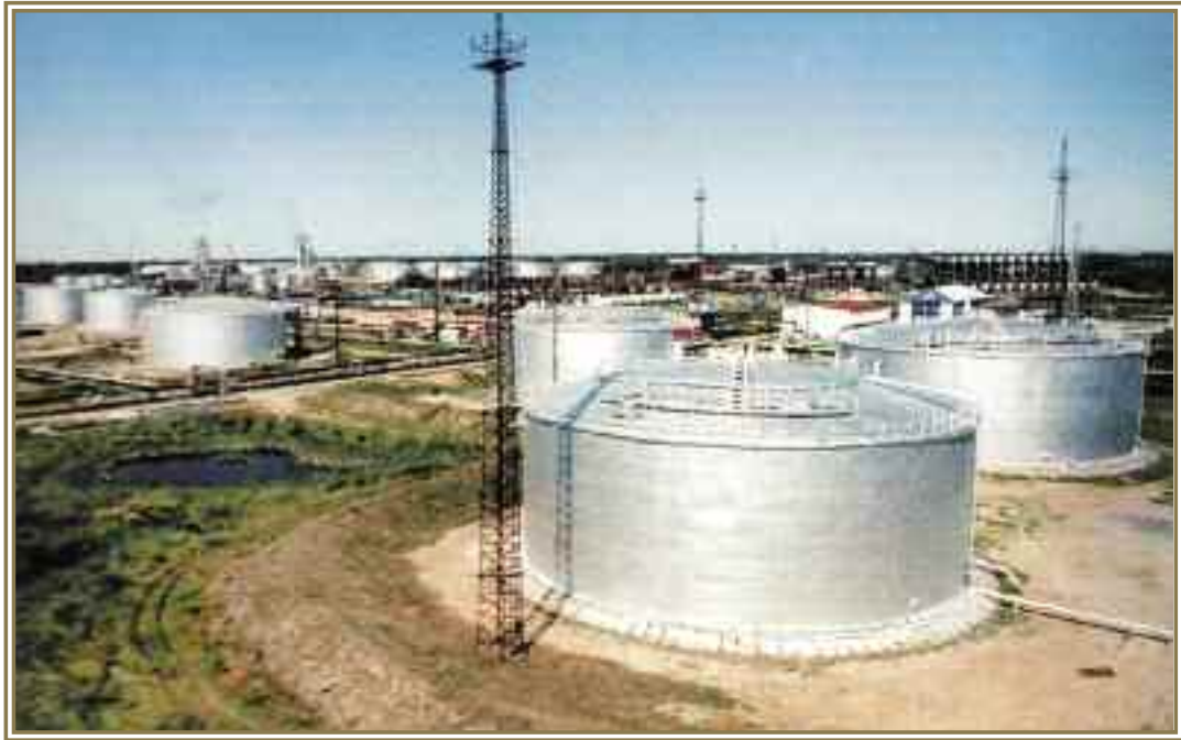
Южный резервуарный парк Самотлора, Тюменская обл.
