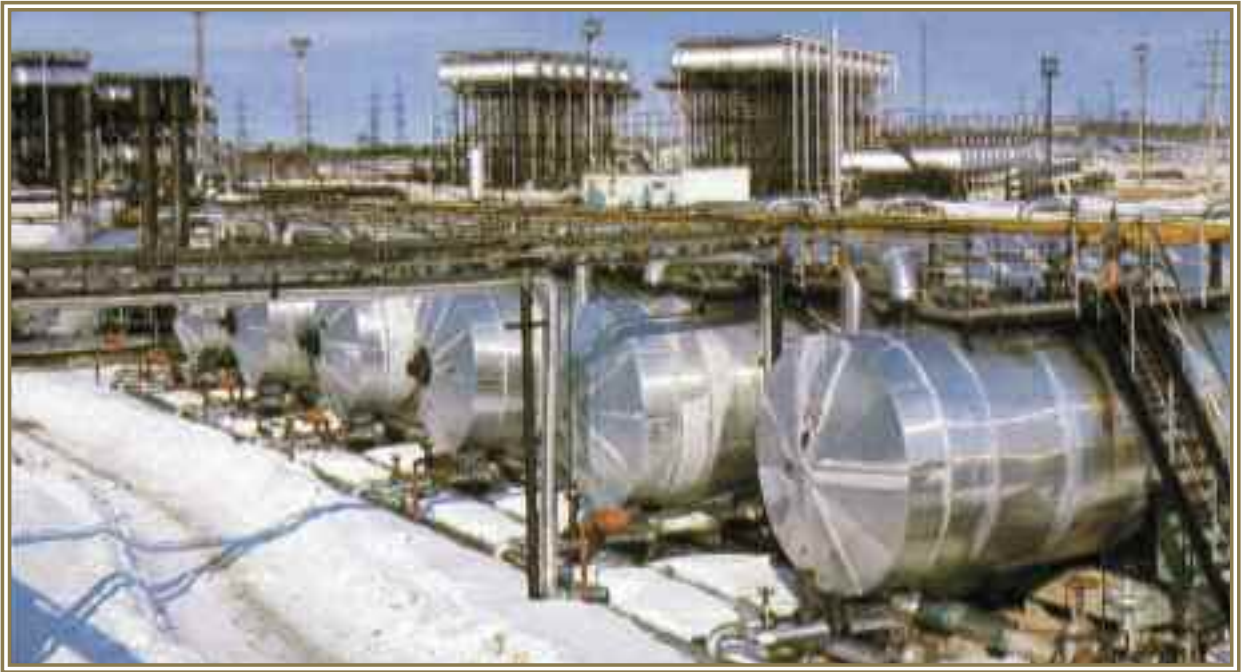
Промысел нефтяного месторождения Самотлор
