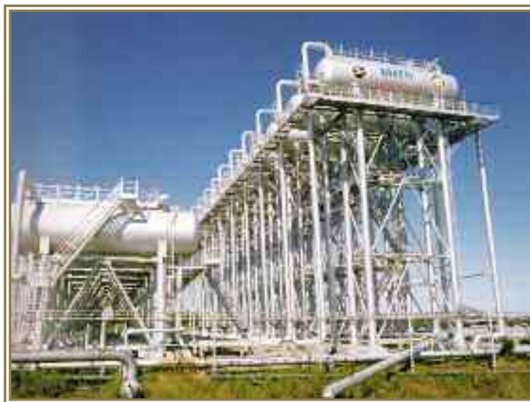
ЦРП Южной части Самотлора. Узел замера нефти концевых сепарационных установок, 1990 г.
