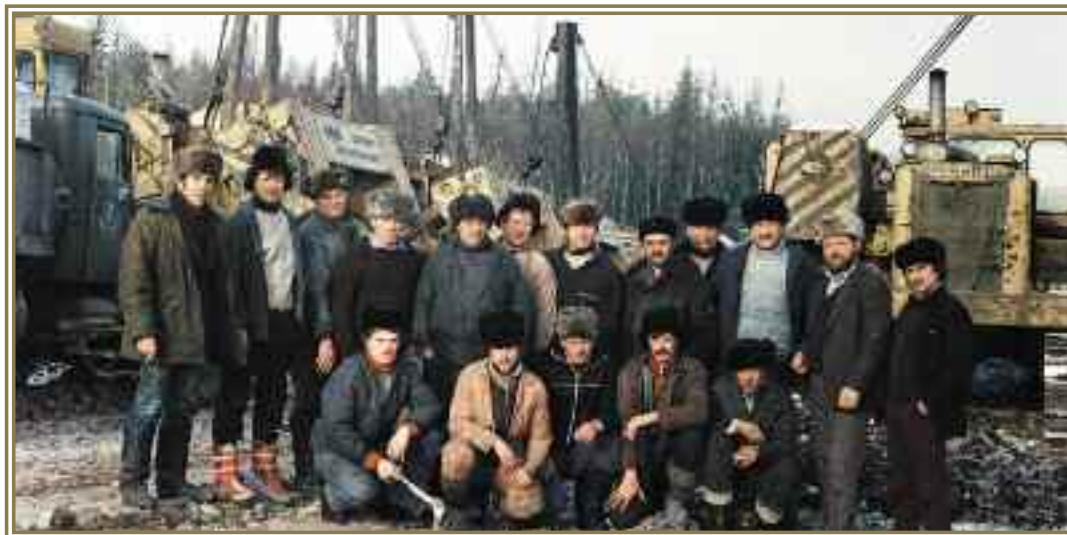
Изоляционно-укладочная колонна А.С. Быкова, газопровод Пунга – Вуктыл, трест Приобьтрубопроводстрой, Тюменская обл., 1976 г.
