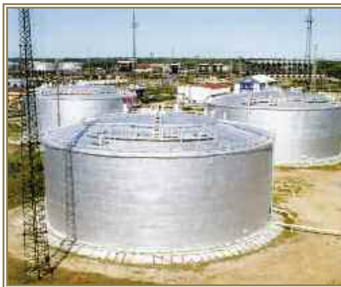
Резервуарный парк нефти Сомотлор
